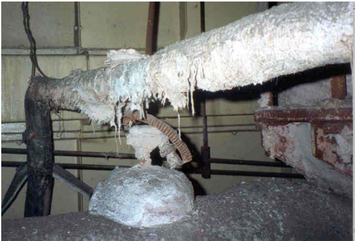
Abb. 4.8 Asbestisolierung an Dampfrohrleitungen
