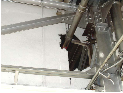
Abb. 4.3 Asbest-Isolierplatte als Trennwand. Dieses Beispiel zeigt die praktischen Probleme bei der Konstruktion einer geeigneten Abdichtung sowie die Flächen, in denen sich beim Entfernen Asbeststaub ansammeln könnte.
