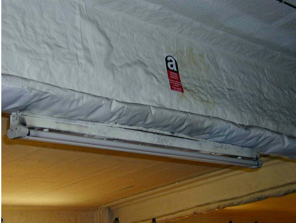
Abb. 4.11 Asbestisolierung an Stahltraeger
