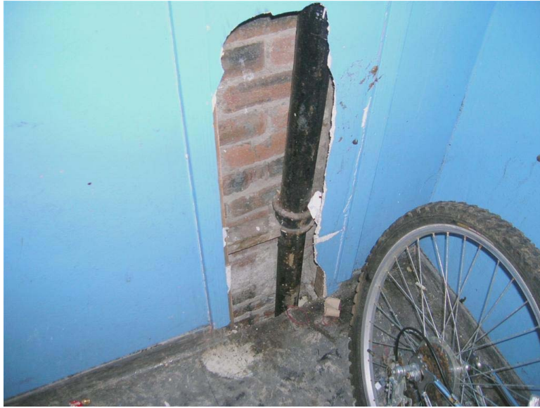
Abb. 6.4 Asbesthaltige Isolierplatte. Die Entfernung der Platte sollte erwogen werden, da die Platte an dieser Stelle leicht beschädigt werden könnte.
