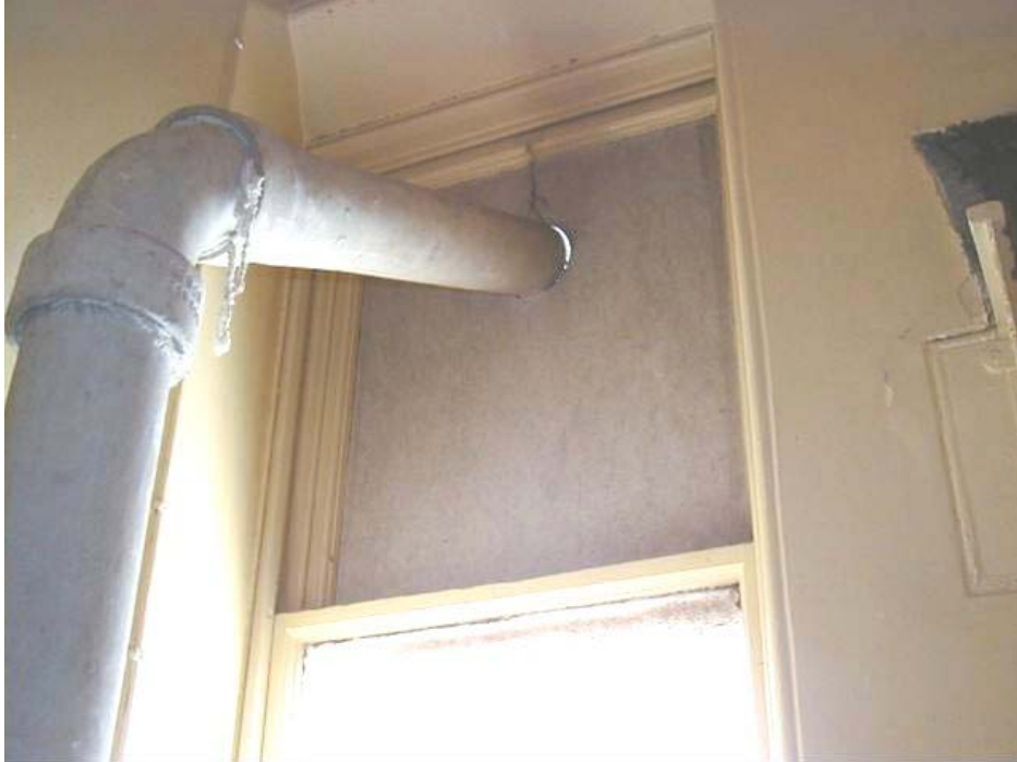
Abb. 4.5 Ein mit Asbestschnur abgedichtetes Abgasrohr aus Asbestzement wird durch ein Füllelement aus Asbest geleitet
